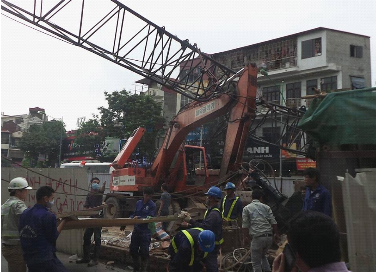
Thiết bị nâng, cần nâng hoạt động gần khu vực điện nhà dân
