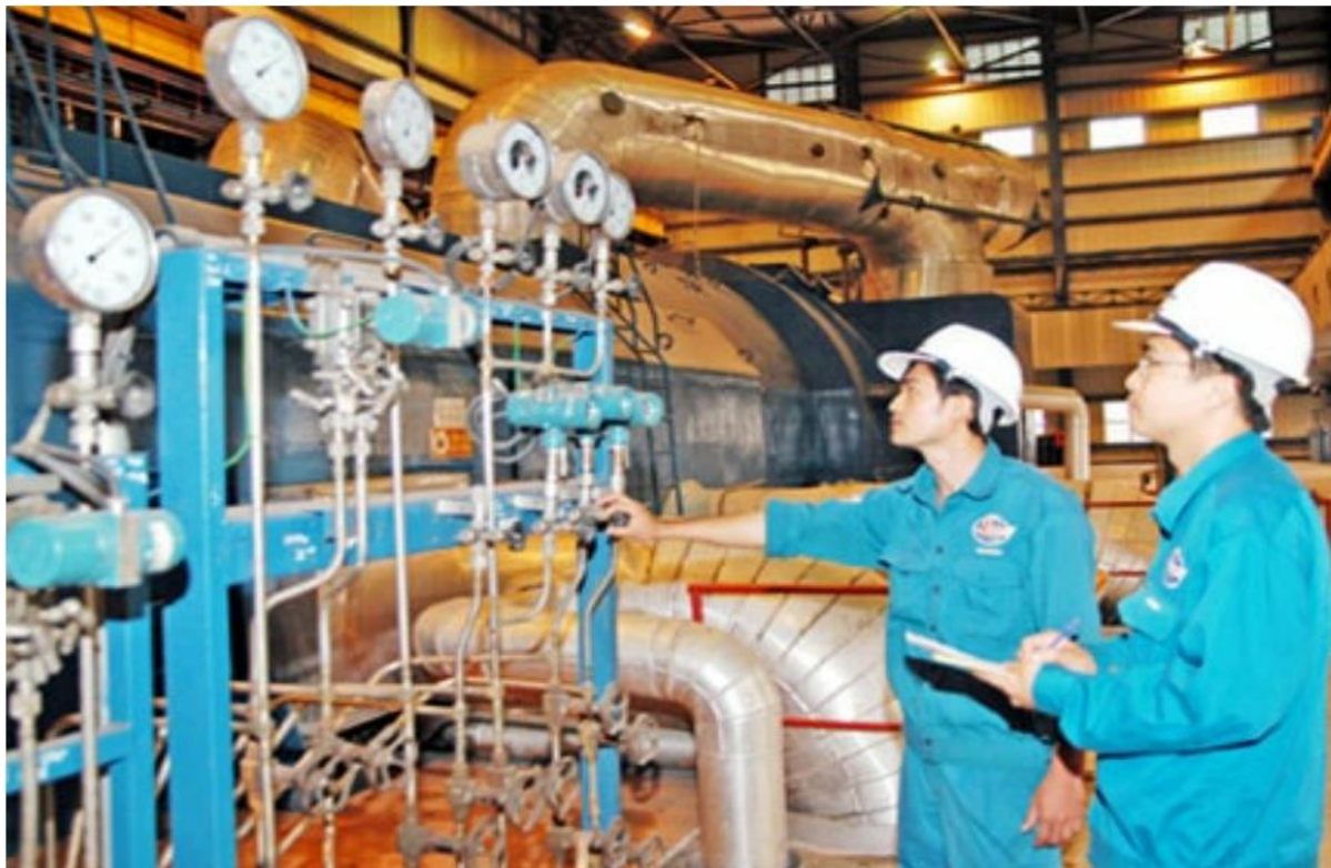
Công nhân kiểm tra vận hành lò hơi nồi hơi công nghiệp
