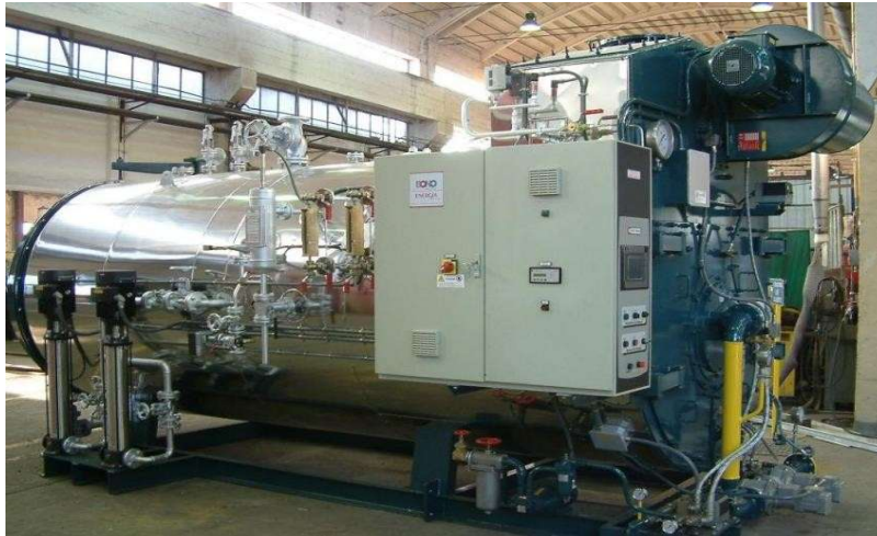
Hình . Thiết bị nồi hơi
